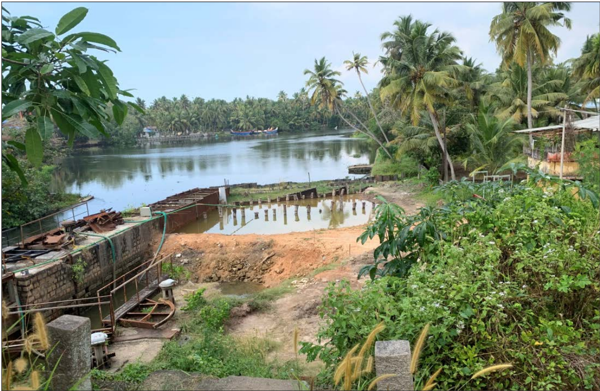
त्रिकुणापुझा में पाइलिंग कार्य – लॉक गेट का निर्माण कार्य प्रगति पर है।
